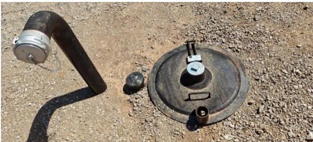
Ouverture citerne 90 à Mirabeau
